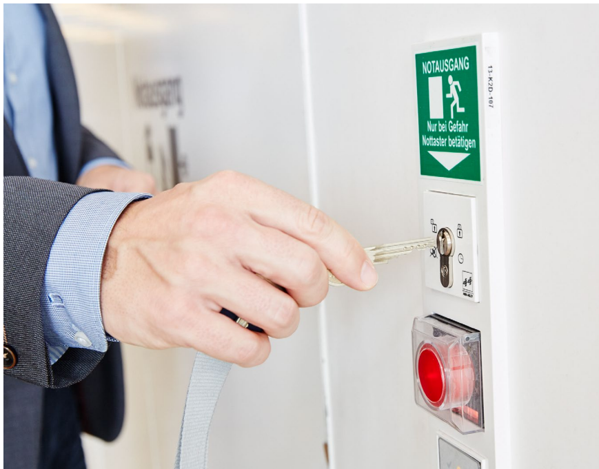
Intégrés dans les terminaux FTS, les commutateurs à clé permettent une ouverture permanente des portes. © Claudia Höhne
